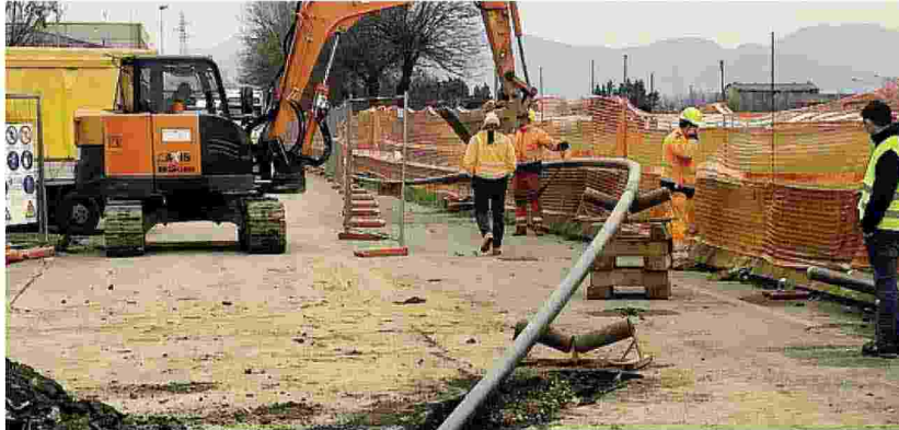
La posa dei tubi per l'ossidotto alla Stemin (Fecs) di Comun Nuovo: scelta strategica sul fronte sostenibile
